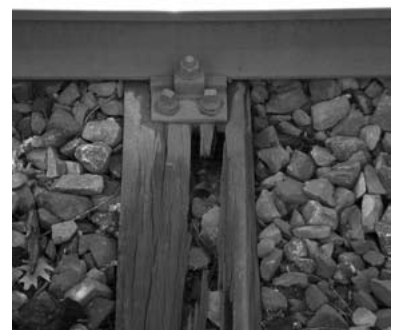
Schwellenschaden am Hauptgleis von Berlin nach Dresden im Bereich des brandenburgischen Bahnhofs Blankenfelde. (Foto: Christian Schultz März 2007)
