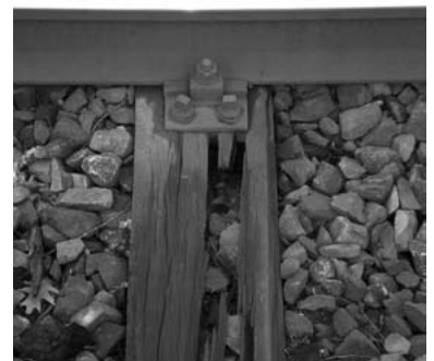
Schwellenschaden am Hauptgleis von Berlin nach Dresden im Bereich des brandenburgischen Bahnhofs Blankenfelde. (Foto: Christian Schultz März 2007)
