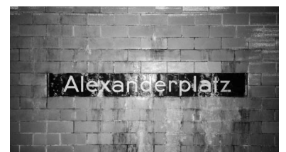
U-Bahnhof Alexanderplatz vor der Sanierung. Die Spuren zeigen, dass Grundwasser durch die Wand dringt und die Fliesen zerstört. (Foto: Udo Dittfurth 1990)
