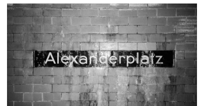
U-Bahnhof Alexanderplatz vor der Sanierung. Die Spuren zeigen, dass Grundwasser durch die Wand dringt und die Fliesen zerstört. (Foto: Udo Dittfurth 1990)
