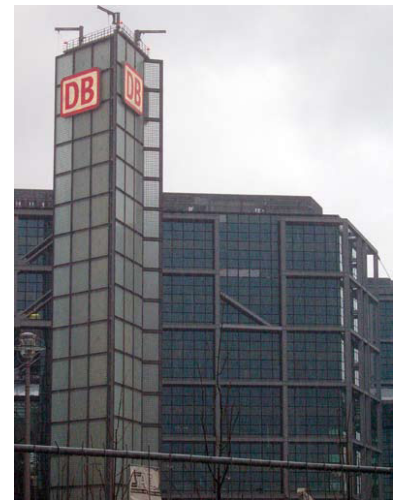
Sturmschaden am neuen Berliner Hauptbahnhof. Ein zwei Tonnen schwerer Stahlträger war aus der Fassade gerissen worden (Bild oben) und auf eine öffentliche Treppe (Bild unten) gestürzt. Durch den Sturz wurde ein zweiter Träger herausgerissen und ein dritter beschädigt. Zum Glück kamen keine Menschen zu Schaden. (Foto: Florian Müller)
