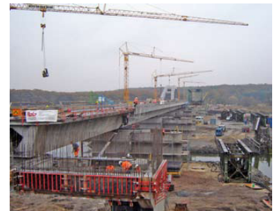
Großbaustelle mit großem Zeitdruck. Innerhalb von zwei Monaten musste die alte Grenzbrücke zwischen Frankfurt (Oder) und Slubice abgebrochen und die neue aufgebaut werden, damit pünktlich zum Fahrplanwechsel am 14. Dezember hier wieder Züge über die Oder fahren können. ( Foto: Karl-Heinz Boßan)
