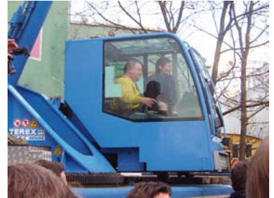
Nachdem der Baubeginn erstmals für 1987 angekündigt war, war es am 15. November 2006 endlich so weit: Verkehrsministerin Ingeborg Junge-Reyer begann mit Hilfe eines Kranes und eines richtigen Kranführers mit den Bauvorbereitungen. Sie hob ein Gleisstück des unbenutzten Logistikgleises aus. (Foto: Florian Müller)
