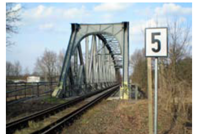
Es ist zweifelhaft, ob der Instandhaltungsrückstand speziell auf Regionalstrecken mit den in der LuFV vorgesehenen Finanzierungsbeträgen tatsächlich abgebaut werden kann. Ein Beispiel von vielen: Die abgebildete Sprebrücke im Verlauf der Strecke Fürstenwalde-Bad-Saarow ist nur noch für 50 km/h zugelassen, die kurz dahinter liegende Brücke über die Bahnstrecke Berlin-Frankfurt (Oder) gerade noch für 30 km/h! (Foto: Ch. Schultz)
