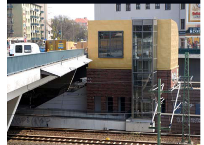
S-Bahnhof Messe Nord (Witzleben), neuer Ausgang zum ICC und Messegelände. Trotz Bestellung des Landes Berlin dauerte es Jahre, bis die DB 2008 mit dem Bau dieses wichtigen Ausgangs begann. Und seit Monaten verschleppt sich die Fertigstellung.
