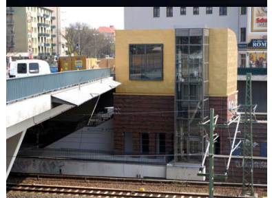
S-Bahnhof Messe Nord (Witzleben), neuer Ausgang zum ICC und Messegelände. Trotz Bestellung des Landes Berlin dauerte es Jahre, bis die DB 2008 mit dem Bau dieses wichtigen Ausgangs begann. Und seit Monaten verschleppt sich die Fertigstellung.
