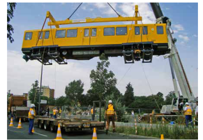
Die acht Fahrzeuge gelangten per Kran durch die Materialeinlassöffnung in den Tunnel, denn einen Gleisanschluss zum U-Bahn-Netz hat die U 55 nicht.
