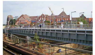
Ringbahnsteig Ostkreuz. Am 31. August, dem ersten Betriebstag scheint zum Glück die Sonne, denn für Regenwetter stehen nur 9 Buswartehäuschen auf dem Bahnsteig zur Verfügung. Immerhin gibt es damit 39 überdachte Sitze. Im Vordergrund das alte Gleis der S 42. (Fotos: Florian Müller)
