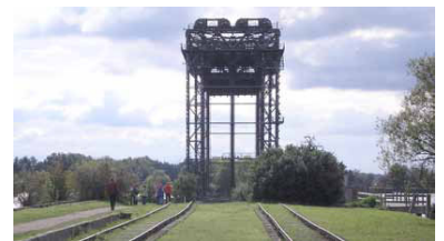
Karniner Brücke. Der Wiederaufbau der Strecke Ducherow--Swinoujscie (Swinemünde) ermöglicht auch eine verbesserte Erschließung von Usedom. Orte wie Karnin, Usedom und auch der Flughafen Heringsdorf (Garz) würden künftig direkt mit der Bahn erreichbar sein. (Foto: Christian Schultz)
