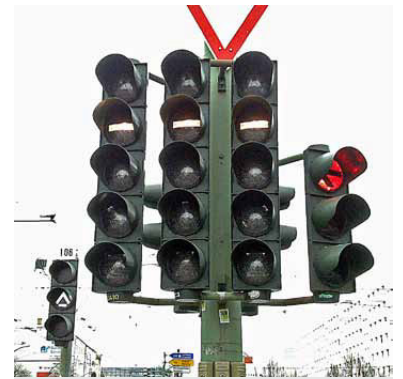
Lichtsignalanlage für Straßenbahnen Landsberger Allee Ecke Petersburger Straße. Der waagerechte Balken bedeutet »Halt« - ein Signaltyp, das die Straßenbahn allzu oft sieht. (Foto: Marc Heller)
