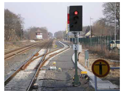
Im Rahmen des jüngsten Umbaus des Bahnhofs Münchenberg (Mark) wurde zwar ein Abstellgleis für das Stärken bzw. Schwächen der Regionalzüge errichtet, Zugkreuzungen von Reisezügen sind aber bereits seit Jahren nicht mehr möglich, da nur noch eine Bahnsteigseite nutzbar ist. Die Flexibilität des Betriebs ist entsprechend eingeschränkt. (Foto: Christian Schultz (Februar 2012))
