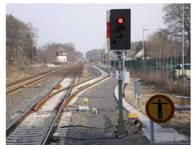
Im Rahmen des jüngsten Umbaus des Bahnhofs Münchenberg (Mark) wurde zwar ein Abstellgleis für das Stärken bzw. Schwächen der Regionalzüge errichtet, Zugkreuzungen von Reisezügen sind aber bereits seit Jahren nicht mehr möglich, da nur noch eine Bahnsteigseite nutzbar ist. Die Flexibilität des Betriebs ist entsprechend eingeschränkt. (Foto: Christian Schultz (Februar 2012))
