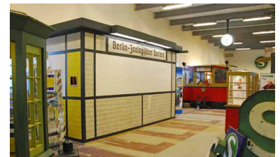
Baustelle S-Bahn-Museum. Hier entsteht ein Dienstraum im Stil der 30er Jahre. (Fotos: Udo Dittfurth)
