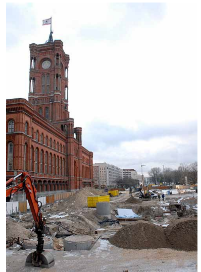
Die Baustelle des teuersten ÖPNV-Projekts Berlins liegt direkt vor dem Roten Rathaus: Die U 5-Verlängerung. Auch dieses Projekt ist zwischen Berliner SPD und CDU unstrittig. (Foto: Marc Heller)
