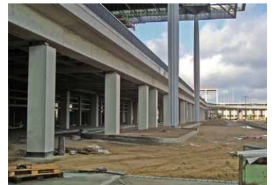
Busse bleiben draußen. Die Bus- und Taxi-Vorfahrt am neuen Terminal BER in Schönefeld im Bau. Während die Taxis direkt in die Galerie unter das Dach fahren können, bleiben die Linienbusse davor. (Foto: Florian Müller)
