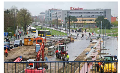
Blick vom S-Bahnsteig Adlershof auf die Rudower Chaussee mit der Baustelle der Straßenbahntrasse auf dem Mittelstreifen. Im Hintergrund das bereits fertiggestellte Rasengleis. (Foto: Florian Müller (14. April 2011))
