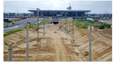
Im Bereich des Flughafens (und damit außerhalb des beklagten Planfeststellungsverfahrens) sind die Arbeiten an der BBI-Ostanbindung weit vorangeschritten. Im Hintergrund der östliche Tunnelmund und der Rohbau des Terminals. (Foto: Florian Müller, Juni 2010)
