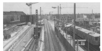
Anfang Januar 1995 am S-Bf Bornholmer Straße. Für die Inbetriebnahmen des Fernbahngleises von Pankow zur Greifswalder Straße finden letzte Arbeiten statt. Das zwischen der Rampe und dem S-Bahnsteig gelegene Gleis führt Schönholz nach Tegel. (Foto: Marc Heller)
