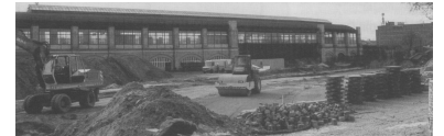
Hier bleibt nichts mehr wie es ist: Auch der denkmalwerte und erst Ende der 80er Jahre für rund 10 Mio DM restaurierte S-Bahnhof Lehrter Stadtbahnhof soll abgerissen werden. Im Vordergrund sind die Bauarbeiten für die vorübergehende Verlegung der Invalidenstraße nach Süden zu sehen. (Foto: I. Schmidt)
