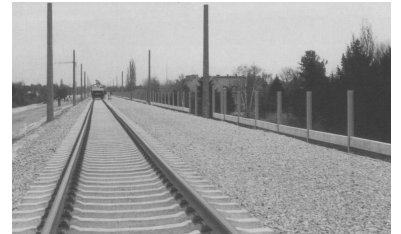
Die Hamburger Bahn in Staaken in Höhe Finkenkruger Weg Anfang März 1995. Die Dammkronen sind mit Schotter versehen, und das nördliche Regional- und Ferngleis ist bereits bis zur Gartenstadt verlegt. Rechts im Bild ist die im Aufbau befindliche Schallschutzwand an der Südseite der Trasse zur Gartenstadt Staaken hin zu erkennen. Links, an der Nordseite der Trasse zu den Häusern am Seegefälder Weg hin, wird entgegen der Darstellung in den ausgelegten Plänen keine Schallschutzwand errichtet. Um diese einseitigen Schallschutzmaßnahmen gibt es nun Ärger. Die betroffenen Anwohner und das Bezirksamt fühlen sich getäuscht und protestieren. Einige Betroffene bereiten Klagen vor. So schafft sich die Bahn unnötigerweise Gegner. (Foto: Heinz-Peter Schwarz)
