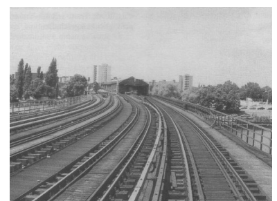
Brücke über den Humboldthafen zum Lehrten Stadtbahnhof. Dieser Abschnitt wird nicht saniert, weil er durch einen südlichen gelegenen ersetzt werden soll. (Foto: Marc Heller)
