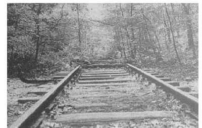
Verrottes Gleis unter einer Brücke zwischen Berlin und Brandenburg (Foto: Ausstellung)
