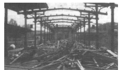
S-Bf. Westend: Die gußeisernen Stützen sollen wieder aufgebaut werden. (Foto: H.-P. Schwarz)
