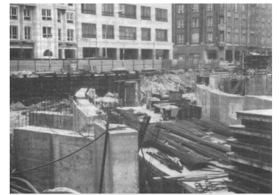
Blick aus der Mohren- zur Friedrichstraße. Südwestlich des U-Bahnhofs Stadtmittel in Berlin (Ost) wird z.Zt. ein Verbindungstunnel zwischen der in Richtung Pankow (Vinetastraße) fahrenden Ost-Berliner Kleinprofilstrecke und der in Richtung Alt-Mariendor fahrenden West-Berliner Großprofilstrecke (U6) gebaut.
