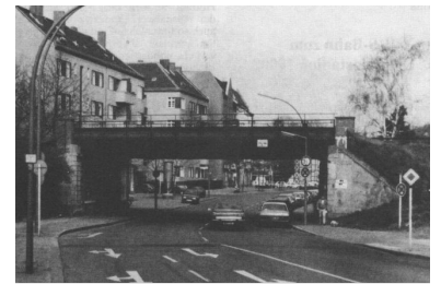
S-Bahn über die Nauener Straße zwischen Spandau-West und Staaken. Der Senat plant den Abbruch, um eine ausreichende Durchfahrtsmöglichkeit für den Umzug der Firma Orenstein un Koppel zu schaffen. Im SIGNAL 4/89 war auf S. 16 versehentlich eine falsche Karte abgebildet. (Foto: H.-P. Schwarz)
