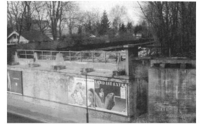
Abgebaute Brücken über die Leonorenstraße am S-Bf. Lankwitz. Bis 1994 wollen die Senatsplaner die Lankwitzer warten lassen, bis hier wieder S-Bahnen fahren. (Foto: REMA)
