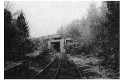
Stillgelegte Anhalter Bahn (S6) und S-Bahn-Zug nach Lichtenrade (S2). Die Sanierung dieser Brückenbauwerke wird vom Senat als erste Baumaßnahme zur Wiederinbetriebnahme der S6 ausgegeben ... (Foto: T. Staack)
