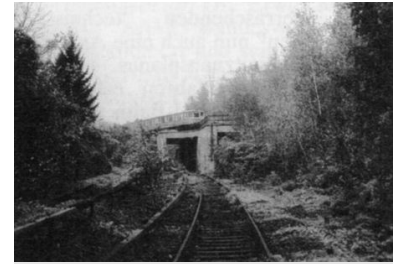
Stillgelegte Anhalter Bahn (S6) und S-Bahn-Zug nach Lichtenrade (S2). Die Sanierung dieser Brückenbauwerke wird vom Senat als erste Baumaßnahme zur Wiederinbetriebnahme der S6 ausgegeben ... (Foto: T. Staeck)
