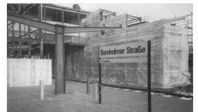
Schon lange vor Abschluß der Arbeiten wurde der S-Bahnhof wiedereröffnet. Der eingerüstete Abgang führt auf den geplanten Bahnsteig B, an dem später einmal alle Züge nach Norden abfahren werden. (Foto: U. Dittfurth)
