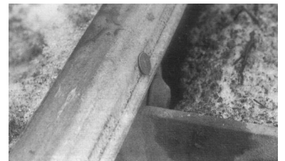
Die Münze verdeutlicht den ausgefästen Schienenkopf im Abschnitt Grätzwalde - Jägerstraße, der in den Sommermonaten erneuert werden soll. (Foto: I. Köhler)
