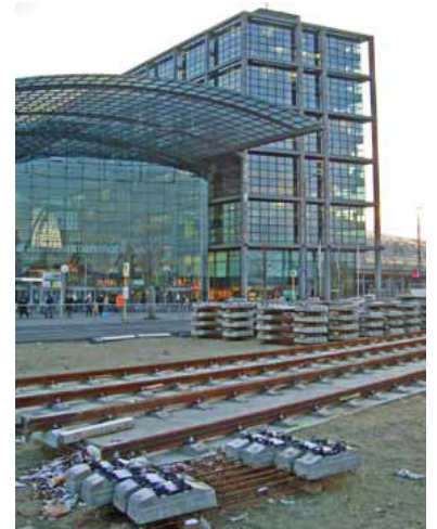
Vor dem Hauptbahnhof liegen zwar schon Gleise, aber die Inbetriebnahme der Straßenbahn wurde inzwischen auf 2014 verschoben. Möglicherweise wird es sogar erst 2015. Hauptursache sollen unerwartete Probleme der Berliner Wasserbetriebe mit den unter der Invalidenstraße vorgefundenen Kanälen sein. (Foto: Florian Müller)
