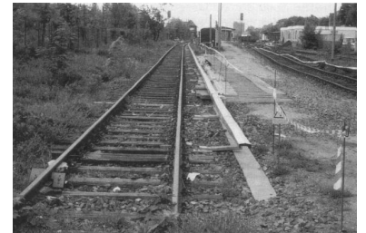
Die neue Stromschiene für die S-Bahn reicht bis zur Gorkistraße. Im Hintergrund der Bf. Tegel. (Foto: Ch. Tschepppe)
