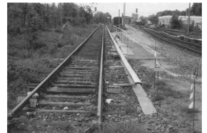
Die neue Stromschiene für die S-Bahn reicht bis zur Gorkistraße. Im Hintergrund der Bf. Tegel. (Foto: Ch. Tscheppe)
