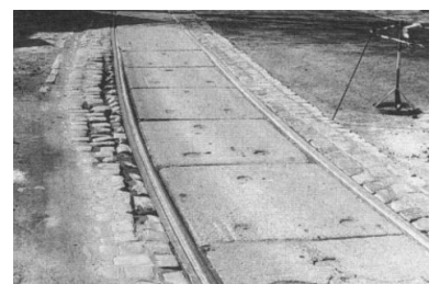
Hönower Straße. Die Fahrbahn wurde instandgesetzt, die Straßenbahnstrecke blieb in katastrophalem Zustand: Abgesackte Randpflasterung, hohlliegende Gleise, verriffelte Schienenköpfe. (Foto: I. Köhler)
