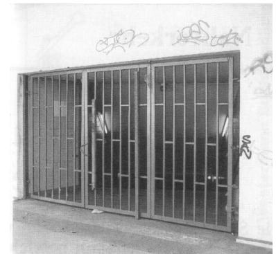
S-Bf. Nordbahnhof, Zugang von der Gartenstraße. Fahrgäste, die nichts von der Tunnelsperrung wußten, standen hier ab 2. April vor verschlossenen Toren, ohne ausreichend informiert zu werden. Lediglich hinter dem Gitter an der seitlichen Wand hängt ein kleiner Zettel mit wenigen Informationen. (Foto: M. Heller)
