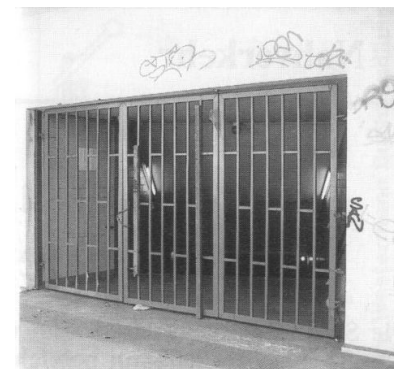
S-Bf. Nordbahnhof, Zugang von der Gartenstraße. Fahrgäste, die nichts von der Tunnelsperrung wußten, standen hier ab 2. April vor verschlossenen Toren, ohne ausreichend informiert zu werden. Lediglich hinter dem Gitter an der seitlichen Wand hängt ein kleiner Zettel mit wenigen Informationen. (Foto: M. Heller)
