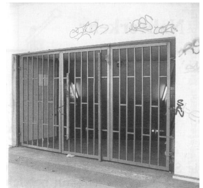
S-Bf. Nordbahnhof, Zugang von der Gartenstraße. Fahrgäste, die nichts von der Tunnelssperrung wußten, standen hier ab 2. April vor verschlossenen Toren, ohne ausreichend informiert zu werden. Lediglich hinter dem Gitter an der seitlichen Wand hängt ein kleiner Zettel mit wenigen Informationen. (Foto: M. Heller)
