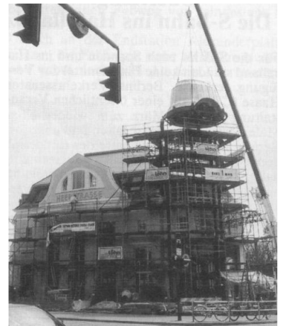
S-Bf. Heerstraße. Seit dem 14. Mai hat das Bahnhofsgebäude wieder seine markante Kuppel. Jetzt fehlt nur noch der S-Bahn-Betrieb. (Foto: E. Kuntzscg)
