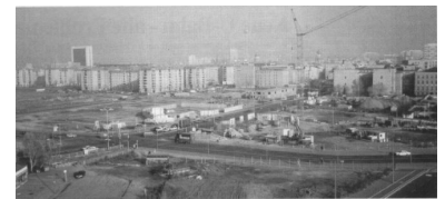
Preisrätsel für Fahrgäste: Finden Sie zwischen Prützen, Schlamm, Container und Zäune den kürzesten Weg zwischen S-Bahn und U-Bahn, S-Bahn und Bus sowie U-Bahn und Bus. Ein Hinweis: Siehe auch die Fotos auf Seite 17. (Foto: I. Schmidt)
