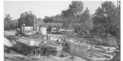
Der Neubau einer Unterführung am Nordkopf des Bahnhofs Neustadt/Dosse dauert länger, als den Fahrgästen versprochen. Am Tag der Aufnahme (20. Mai 1999) wurde gesagt, daß über die hier noch im Bau befindliche Brücke ab 29. Mai 1999 wieder Züge fahren. Daraus wurde natürlich nichts, jetzt heißt es: 12. Juli 1999 (Foto: Sven Jagdhuhn)
