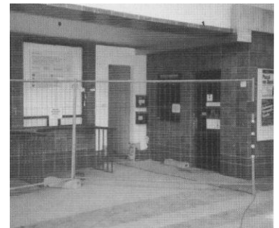
So sieht es hier inzwischen nicht mehr aus. Wände und Böden wurden herausgebrochen und ersetzt. (Foto: Stephan Müller)
