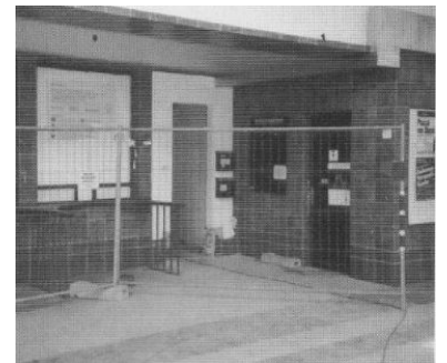
So sieht es hier inzwischen nicht mehr aus. Wände und Böden wurden gerausgebrochen und ersetzt. (Foto: Stephan Müller)
