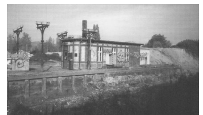
Abriß des alten S-Bahnsteiges Papestraße im Dezember 1999. Hier soll ein wichtiger Umsteigebahnhof zwischen der S-Bahn, dem Regional- und Fernverkehr entstehen. Die Deutsche Bahn AG überlegt derzeit, auf den Bau des Fernbahn-Haltes zu verzichten. (Foto: Frank Böhnke)
