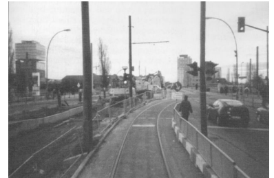
Der Einbau der Straßenbahngleise für die Linie 20 über die Warschauer Brücke zum U-Bahnhof Warschauer Straße macht Fortschritte. Auf den Weiterbau über die Oberbaumbrücke Richtung Hermanplatz werden wir aber noch warten müssen... (Foto: Frank Brunner, März 2000)
