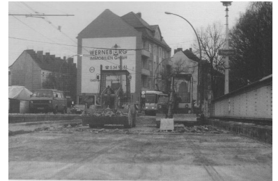
Nach Anfangsproblem hat die BVG den eingleisigen Abschnitt auf der Treskowbrücke, der während der Bauarbeiten eingerichtet wurde, in den Griff bekommen. Im Interesse der Fahrgäste, denen der Schienenersatz-Verkehr erspart bleibt. (Foto: Alexander Frenzel, Februar 2000)
