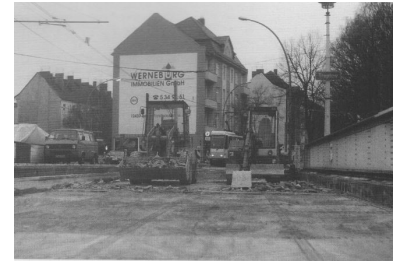
Nach Anfangsproblem hat die BVG den eingleisigen Abschnitt auf der Treskowbrücke, der während der Bauarbeiten eingerichtet wurde, in den Griff bekommen. Im Interesse der Fahrgäste, denen der Schienenersatz-Verkehr erspart bleibt. (Foto: Alexander Frenzel, Februar 2000)
