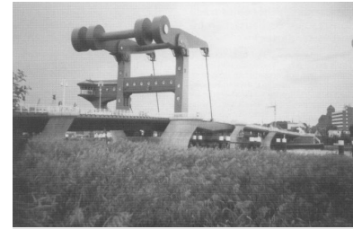
Die seit Mai 2000 auch durch die Eisenbahn befahrene Klappbrücke bei Wolgast. Trotz der neuen Brücke kommt es in der Saison zu langen Wartezeiten. Abhilfe könnte ein Wiederaufbau der Hubbrücke der Karnin bieten! (Foto: Reinhard Hübener, Oktober 1999)
