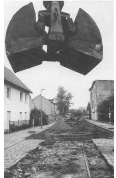
... das soll jedenfalls nach dem Entwurf zum StEP Verkehr nicht die Zukunft der Straßenbahn in Berlin sein! (Abbau von Gleisen in Altglienicke) (Foto: Irmgard Schmidt)
