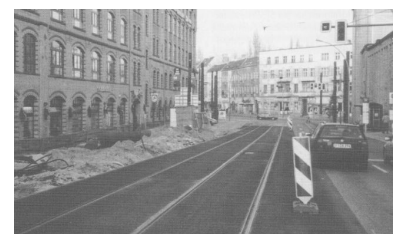
Straßenbahnschleuse ohne Straßenbahnverkehr - aber mit Behinderung der SEV-Busse. (Foto: Matthias Gibtnier, Dezember 2000)
