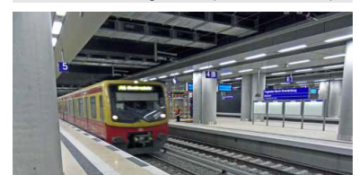
Solange die Brandschutzanlage des Bahnhofes, die nach Auskunft der DB für sich funktioniert, noch nicht mit der nicht funktionierenden des Terminals zusammenarbeiten kann, sind im Tunnelbahnhof Sicherheitsmitarbeiter als Brandwachen tätig (im Hintergrund). (Foto: Tom Gerlich)
